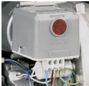
Automatika se zapalovacím transformátorem
